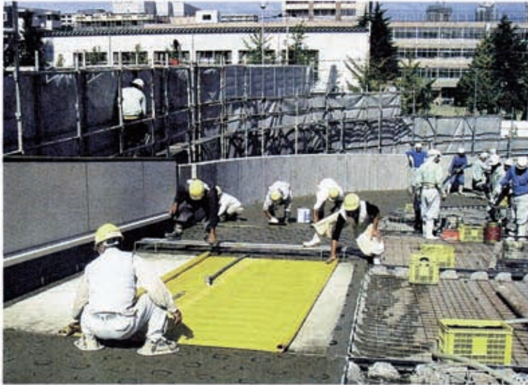
駐車場スロープの工事。コンクリート強度を高める新工法を導入した。2008年10月、新潟市中央区
