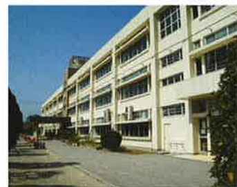
推定震度 5強 ■小学校 EXPJの破壊や窓ガラスが割れた。地震による外壁の被害は確認されなかった。
