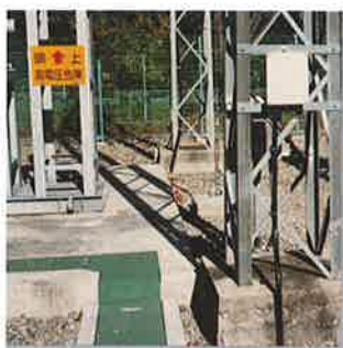
発電所・変電所
