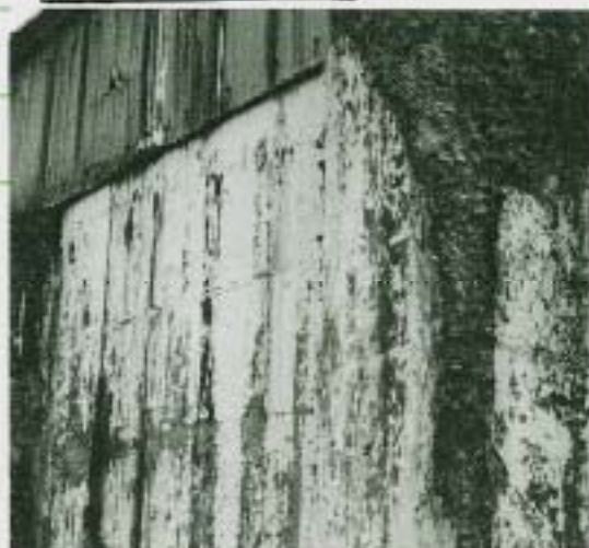
凍害で劣化した建物▶
