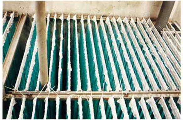
農業集落排水処理施設 設置状況
