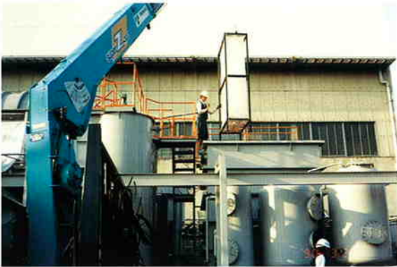
塗装排水処理施設
