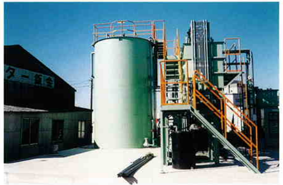
メッキ排水処理施設
