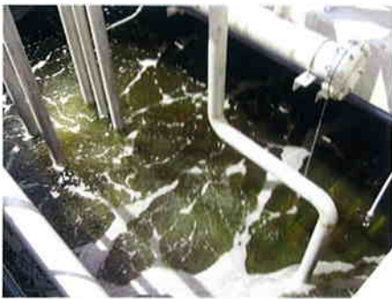
最終処分場 浸出水処理施設
