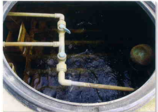
水リサイクルシステム (稼動中)
