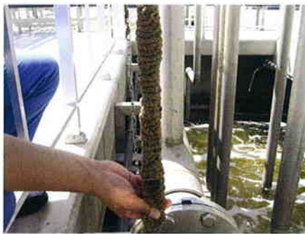
浸出水処理施設 硝化槽汚泥付着状況
